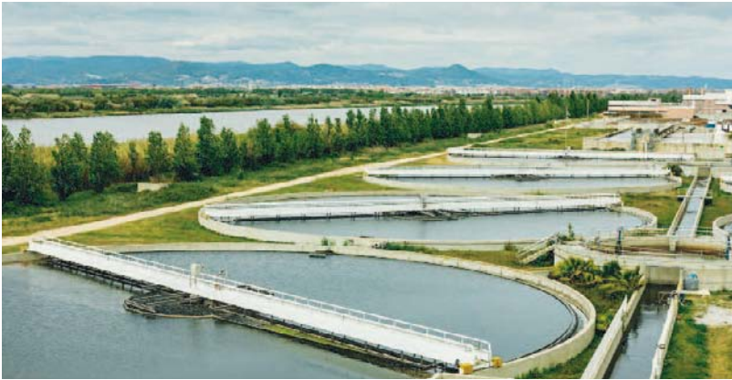
Las instalaciones de la ecofactoría del Baix Llobregat (Barcelona)
